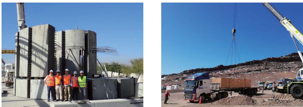
図 2.5: (左) 望遠鏡ピアおよびエンクロージャのプレキャスト基礎の仮組試験, (右) 標高 4,950m サイトに到着したエンクロージャの構成部品.
