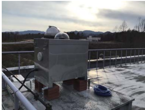
図 3.32: 夜天光観測棟屋上に設置された全天カメラ
