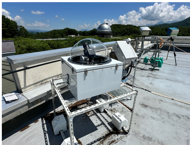
図 3.22: 屋上に設置されている外部機関カメラ収納箱（手前の2つ）
